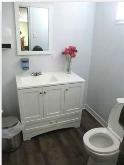
Salle d'eau des bénévoles Fondation Home Depot
